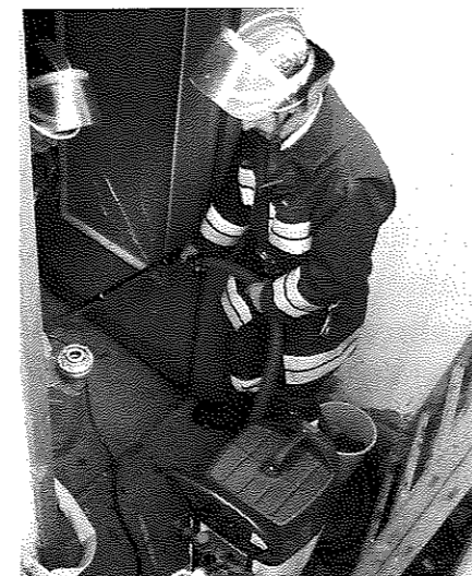
Mit der entsprechenden technischen Ausrüstung konnte die FF Lorenzen das Wasser aus dem Keller absaugen.
